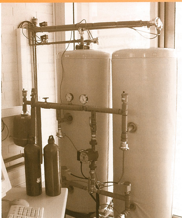
Vista de la instal·lació interior (amb dipòsits de Lapesa, SA).
